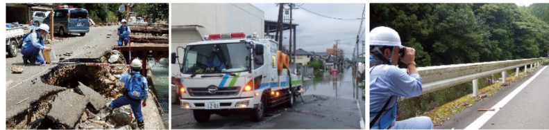
道路の被災状況調査 【令和2年7月豪雨】
