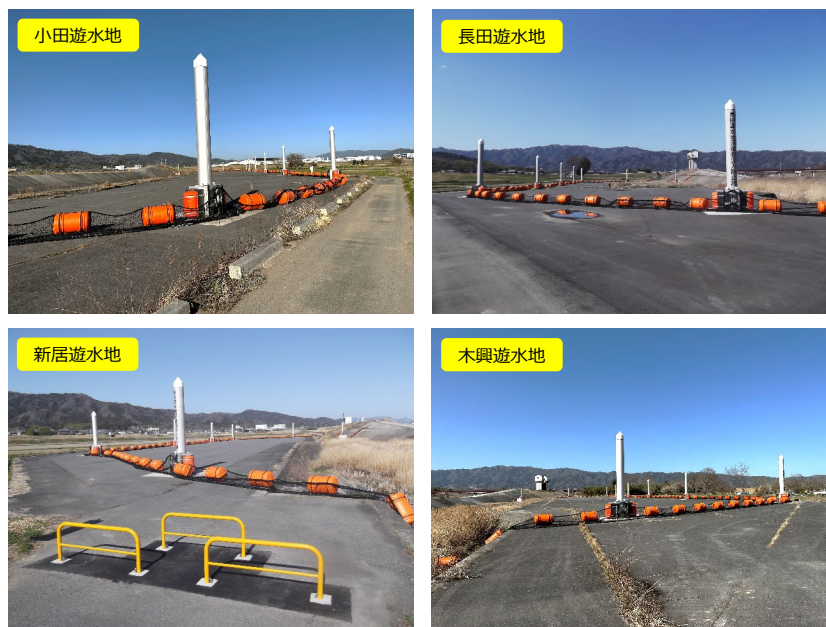
図 6.2.3 浮遊物流入防止施設
