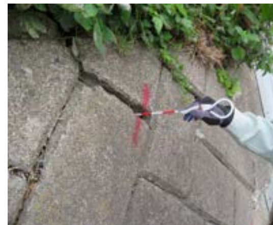
変状(ポール貫入)状況
