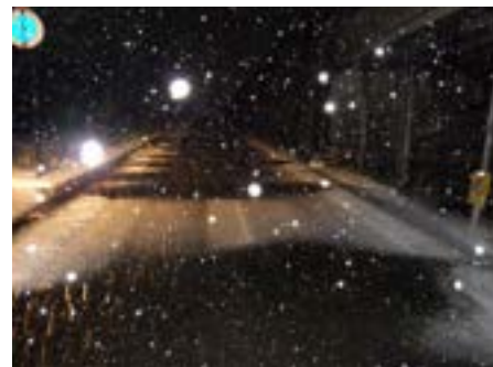
散水融雪設備の作動状況
