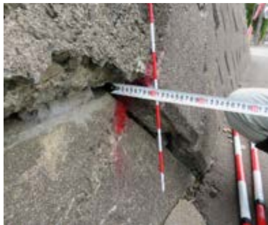
壁面変状(ズレ)状況
