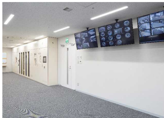
平城宮跡管理センター（中央監視盤）
